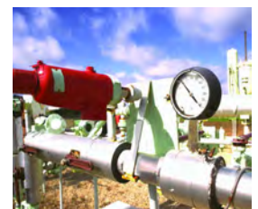
Rozvody plynu: vlhkost způsobuje poškození a snižuje hodnotu plynu v systému
