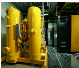
Systémy tlakového vzduchu: monitorování sušičky pro předcházení poškození, způsobeného vlhkostí
