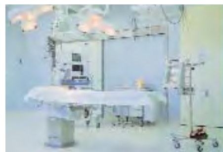
V nemocnicích a výzkumných laboratořích předchází tlakový spád (podtlak) šíření zárodků a prachu.
